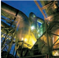
Leitungssystem in einem Zementwerk
